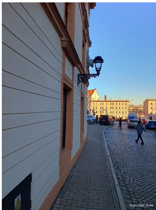
ul. Długa – lampa oświetleniowa z oprawą wymienioną w ramach Rozświetlonej Polski
