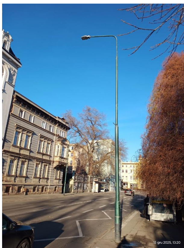
ul. Zamkowa – lampa oświetlenia ulicznego z oprawą oświetleniową wymienioną w ramach Rozświetlonej Polski
